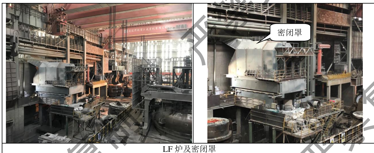
图 2.2.7 合金熔化炉与 LF 炉废气处理措施
